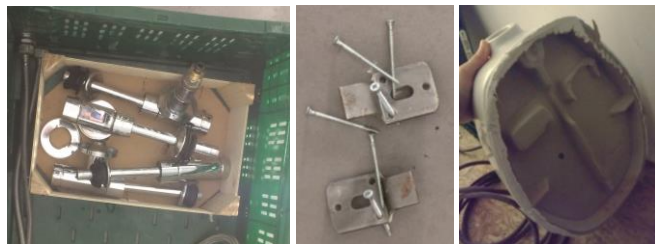
Figure 3a, 3b et 3c : Arrivée d'eau des urinoirs avec ou sans la pièce de raccord ; 3b : les pièces de support ; 3c : urinoir cassé
