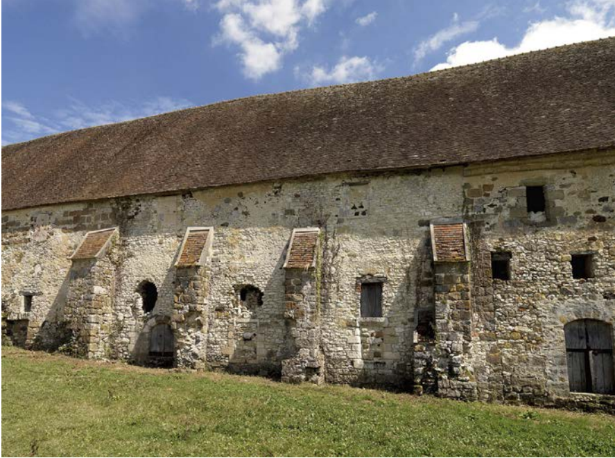
Fig. 2. Au milieu de la Grange des Beauvais, les salles 3 et 4, se signalent à l'extérieur par les puissants contreforts qui soutiennent les murs latéraux. (cliché Inventaire général IDF, J.-B. Vialles)
