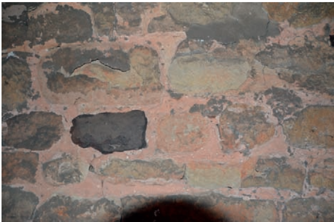
Fig. 12. Vue des maçonneries intérieures de la tour, deuxième étage, présentant des pierres calcinées et du mortier roussi (cliché Paulo Charruadas, 2013)
