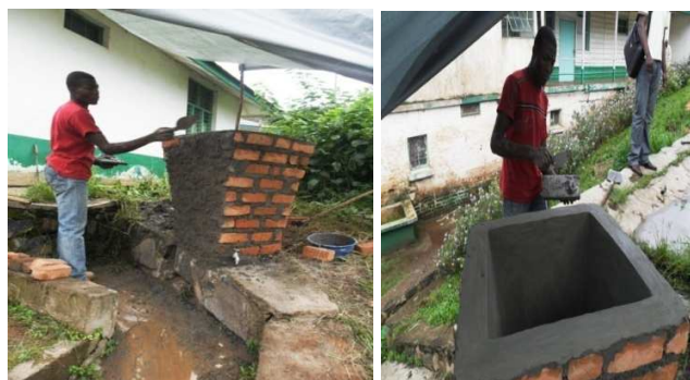
Figure 1. Plate forme expérimentale : la compostière.
